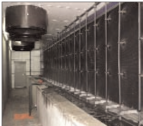
Skupiny trysek rozprašují vodu na přední stěny filtrační stěny, aby na ní nemohl ulpět prach.
