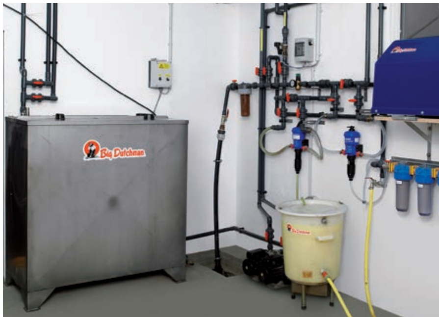
Předprostor s malou (60 l) a velkou (1000 l) nerezovou nádrží na směšování medikamentů
