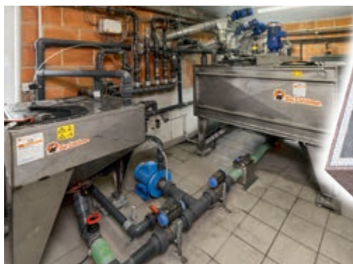
Krmná kuchyně: Zařízení s 1 nádrží a váženým tankem na použitou vodu
