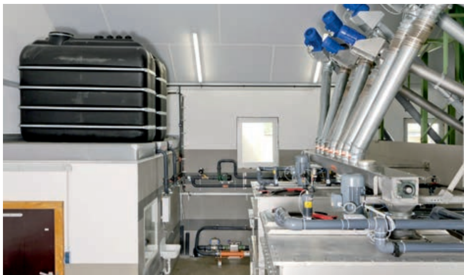
Krmná kuchyně s bezzbytkovým krmením o 2 nádržích a dvěma nádržemi na 2000 l čisté vody
