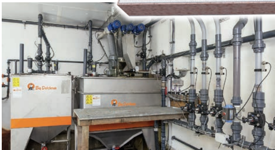
Krmná kuchyně: Zařízení s 1 nádrží, tankem použité vody a čtyřmi větvemi JET
