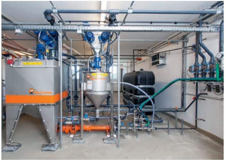
Krmná kuchyně: Zařízení s 2 nádržemi a tankem na použitou vodu
