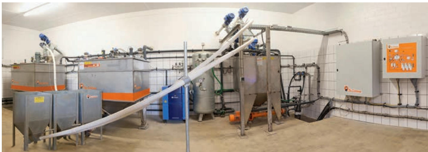
Pohled do krmné kuchyně s mokrým krmením HydroMix na bázi tlakového vzduchu ve stáji odchovny selat a jednou nádrží bezzbytkového krmení pro stáj prasnic
