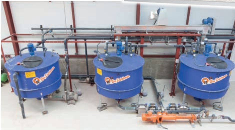
Krmná kuchyně: Zařízení s 2 nádržemi a tankem na použitou vodu
