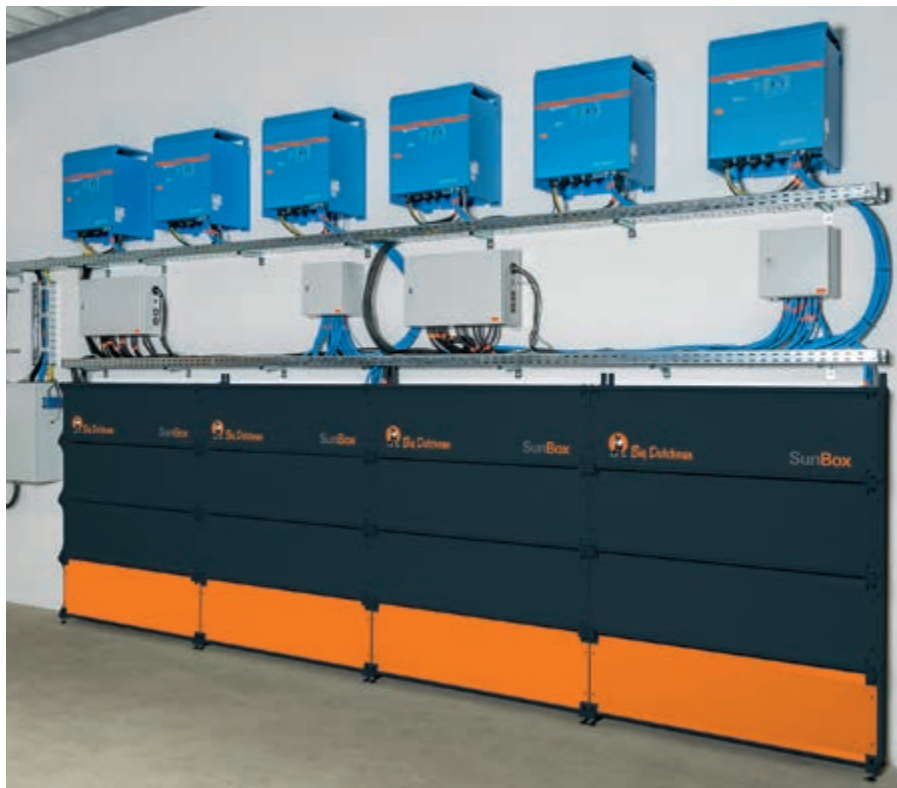
16 modulů s celkovou kapacitou 224 kWh
